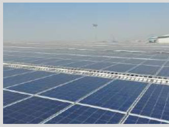
4 MW (Ahmedabad - Gujarat)
