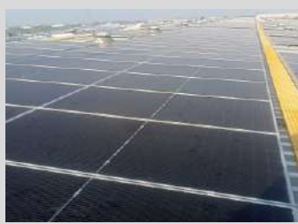
1.25 MW (Kheda - Gujarat)
