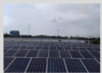
1 MW (Dahej - Gujarat)
