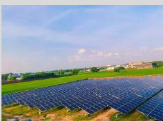
1.35 MW (Paldi - Gujarat)
